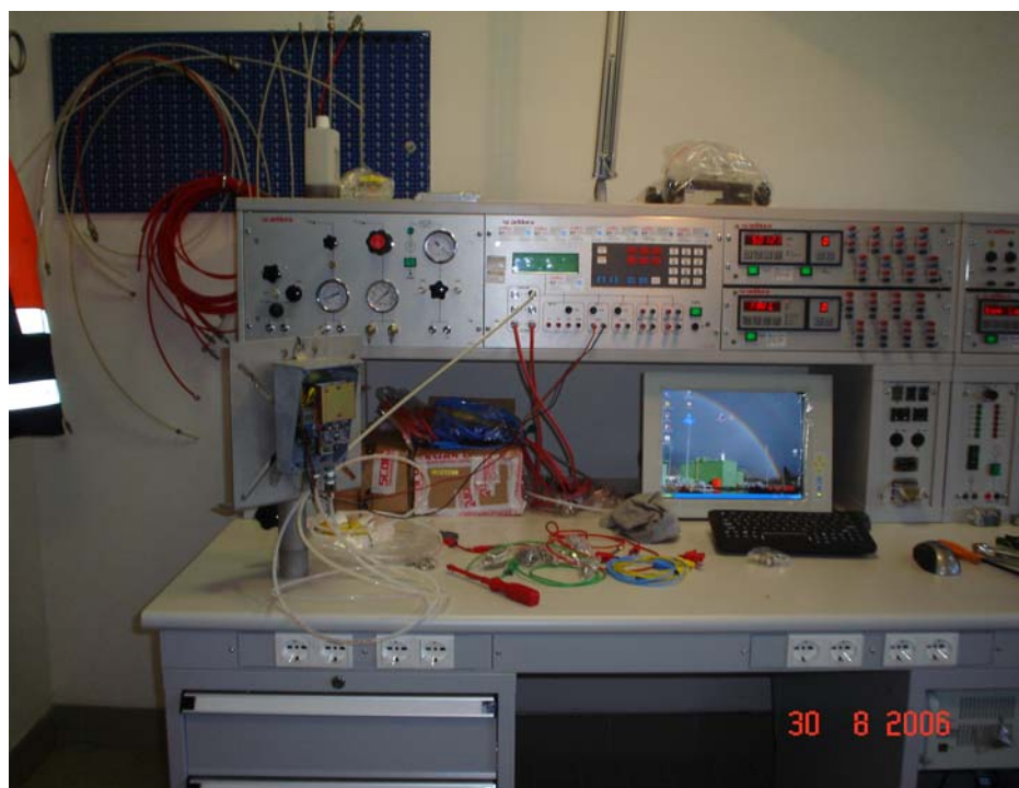
Nelle foto i banchi della centrale di compressione di Terranova Bracciolini
