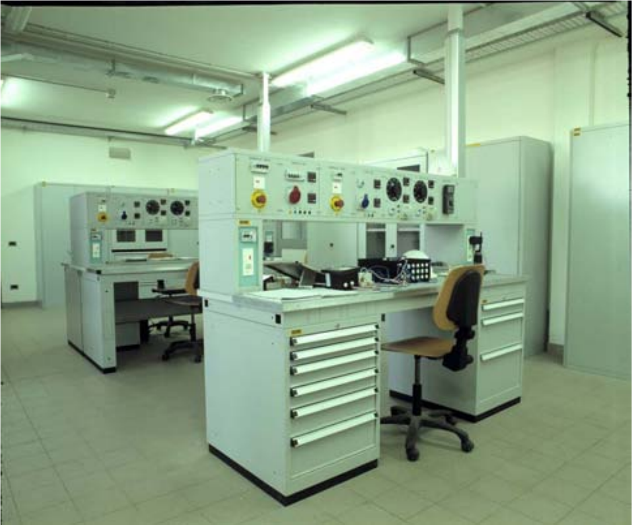
Sala test e controlli installata presso una delle più moderne cementerie
