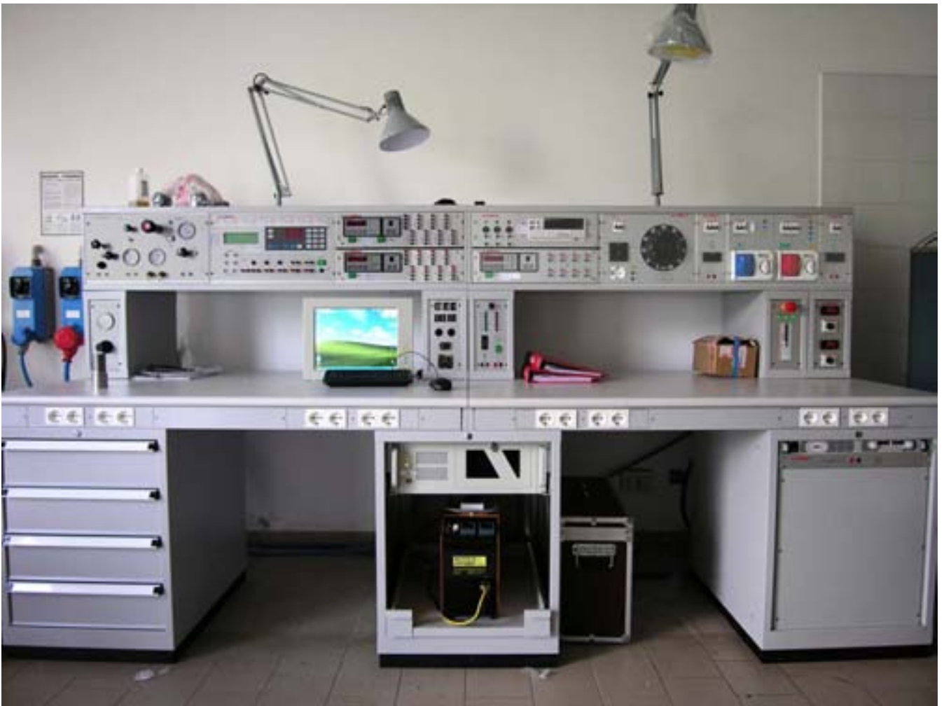
Impianto di controllo e misure installata in una centrale di rete di distribuzione gas
