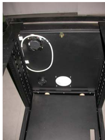
Vista interna del retro asportabile con impianto elettrico estrazione calore
